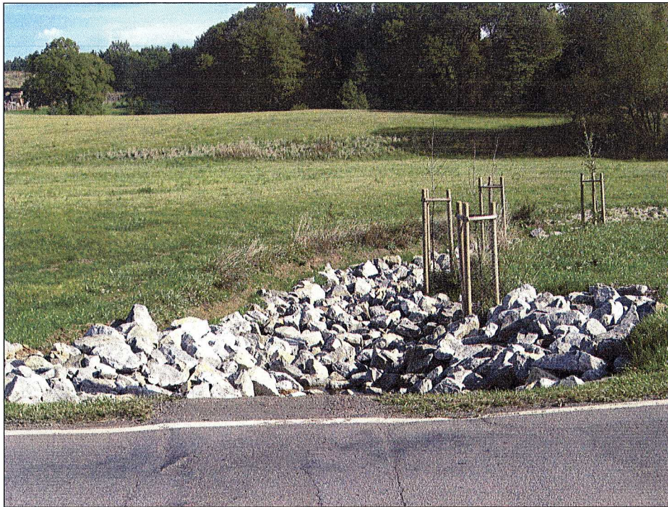
Bild 15: Deponie Grumbach, S 192 – Straße von Tharandt nach Grumbach, befestigtes Bachprofil nach dem Straßendurchlass DN 600, 09.10.2006
