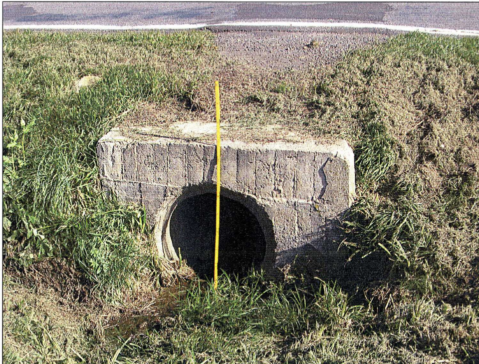
Bild 14: Deponie Grumbach, S 192 – Straße von Tharandt nach Grumbach, Straßendurchlass DN 600 für die Ableitung des Vorfluters „Gründchen“ in Richtung Schloitzbach, 09.10.2006
